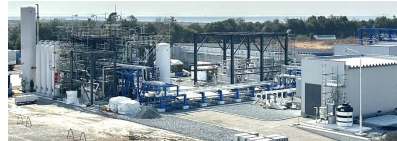
水素製造設備(建設中)
